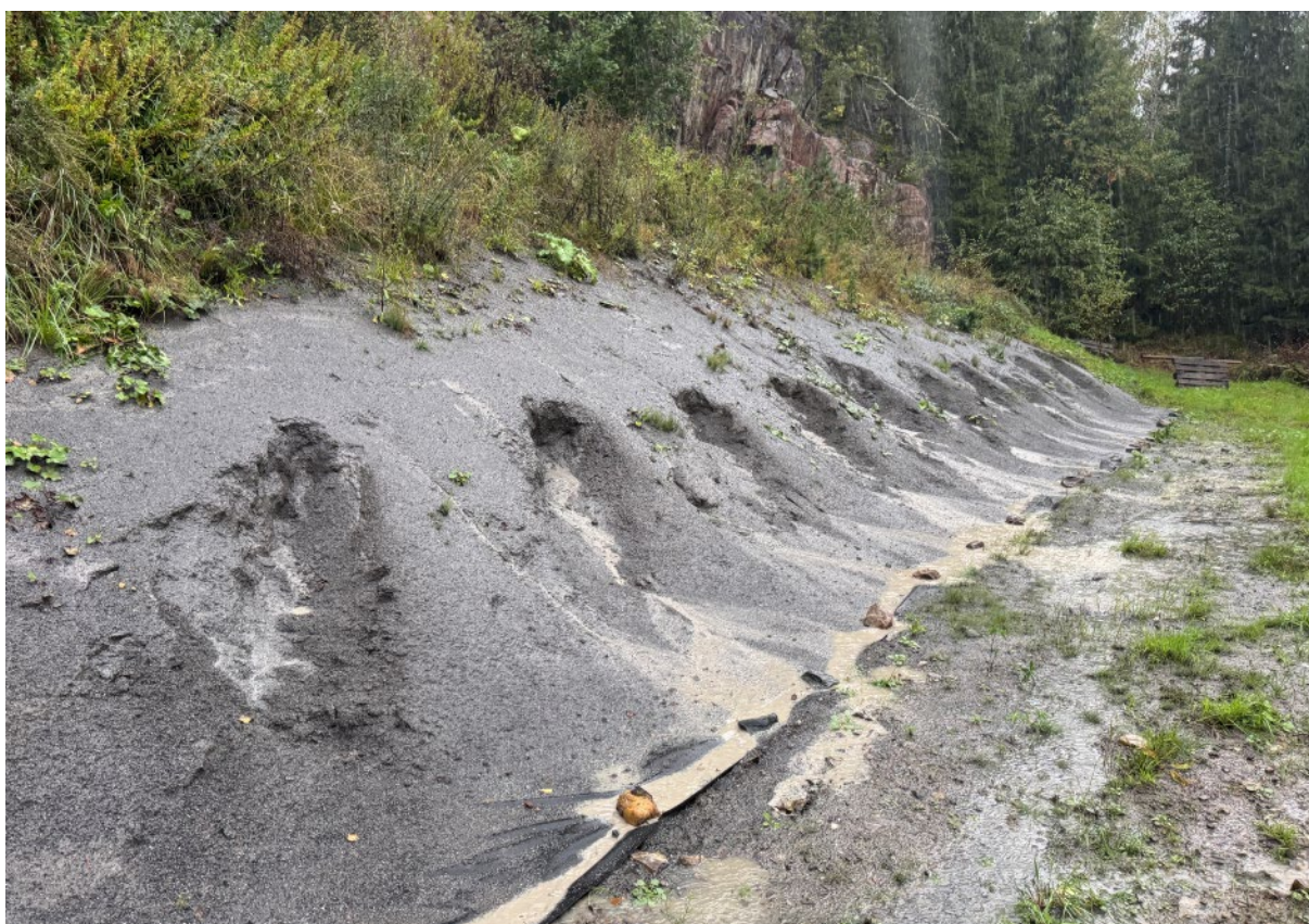
Figur 39 Maskinsanden vaskes ut ved kraftig regn, og dekker nesten fiberduken over grøften
