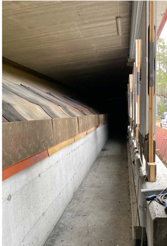
Figur 13 Innsiden av skivehuset / kulefanget
