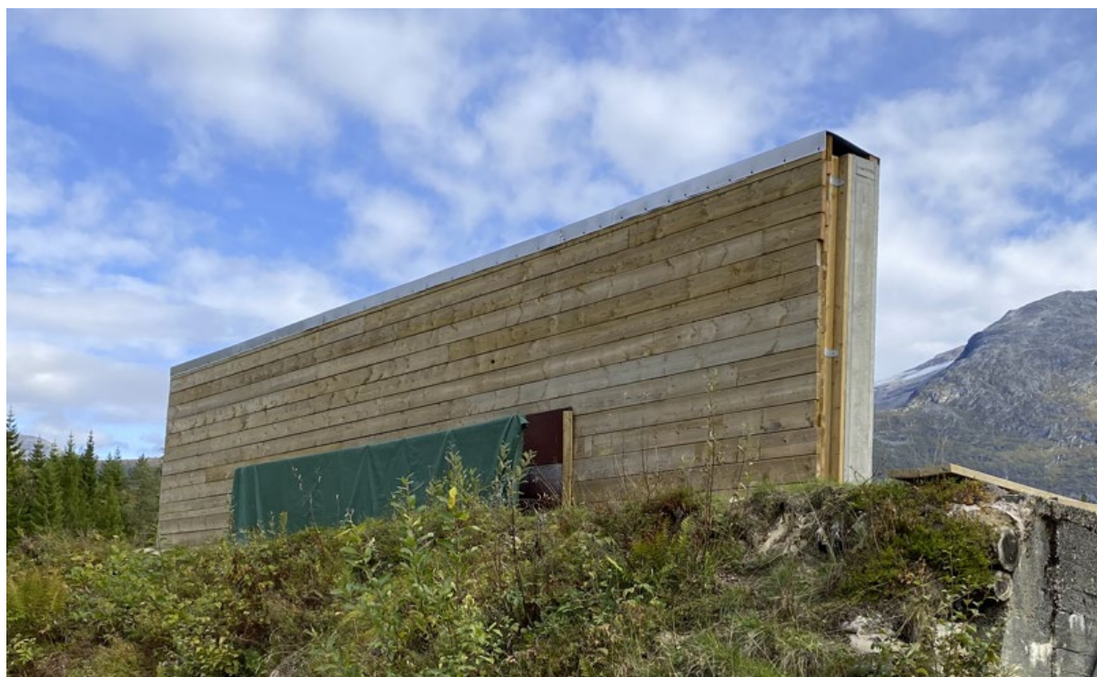
Figur 25 Kulefangvegg med innvendig vertikal stålplate og oppsamlingsrenne for kulerester (på bildet er skivene dekket av en grønn presenning)
